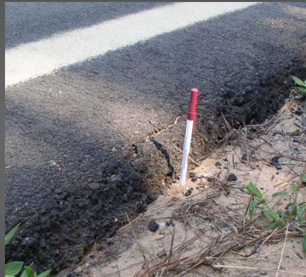
No Safety Edge
